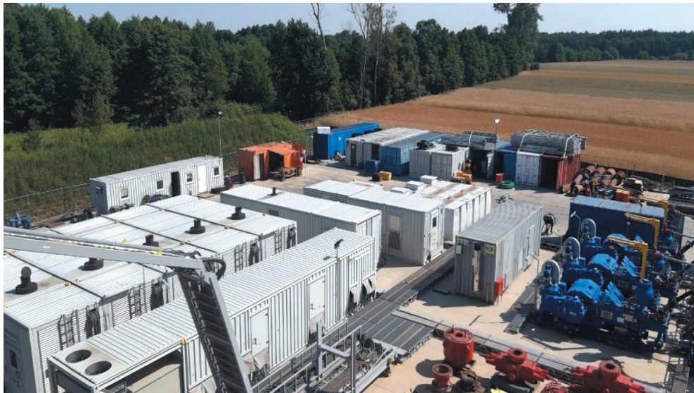
Rys. 6. Kontenerowa zabudowa zasilania urządzenia Bentec 2000 HP (fot. Daraż PGNiG S.A.)
