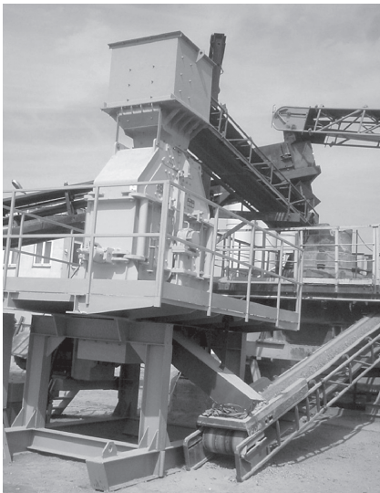
Rys. 6.69. Brak prawidłowego połączenia rynny odprowadzającej produkt z taśmociągami (Löwe 2010)
