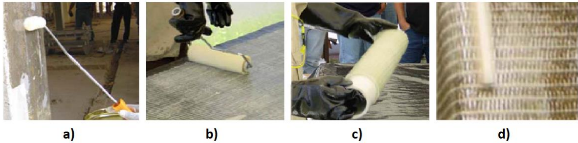
Rysunek 6. Etapy w procesie mokrego układania: a) wzmocnienie podłoża betonowego, b) nasączenie zbrojenia, c) umieszczenie nasączonego FRP na wałku, d) usunięcie pęcherzyków powietrza za pomocą wałka z tworzywa sztucznego. Źródło: [27].
