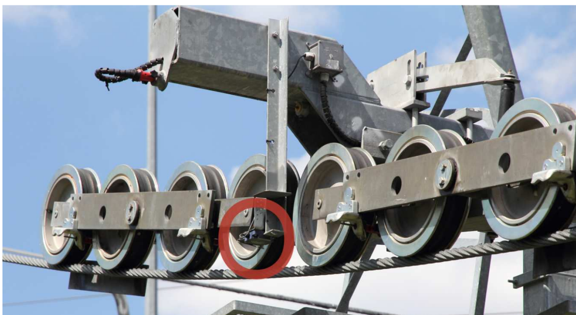
Rys.VII.1. Zestaw baterii krążkowych na podporze P2 z zaznaczonym czujnikiem indukcyjnym.
