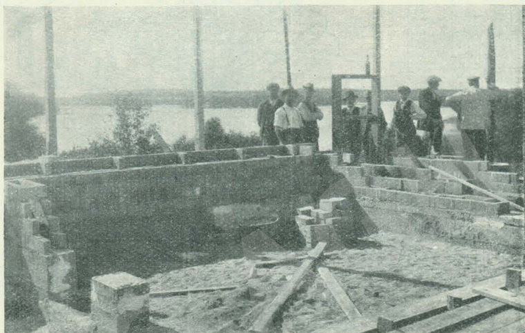
Fot. 174. Murowanie ścian z cegły cementowej z pustymi przestrzeniami. Fundament przy tym budynku zrobiony jest z sypanego betonu.
