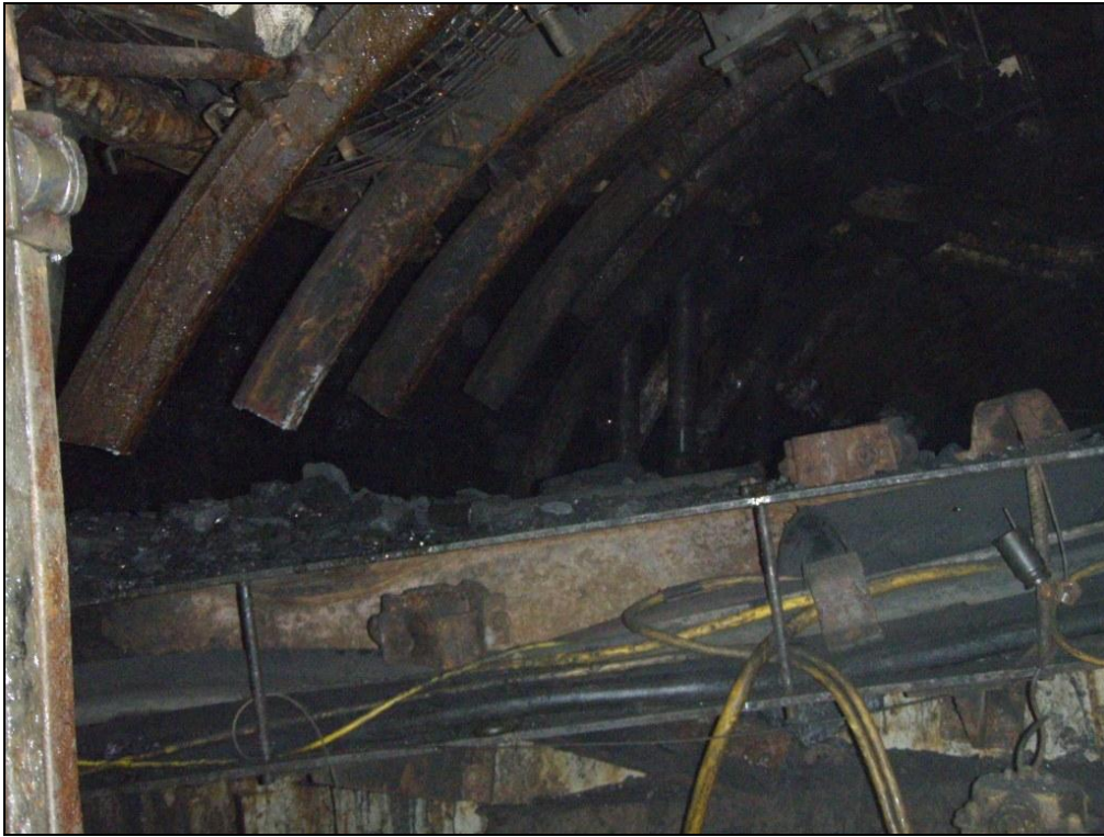
Rys. 4.18 Zdemontowane luki ociosowe na skrzyżowaniu ściana - chodnik.
