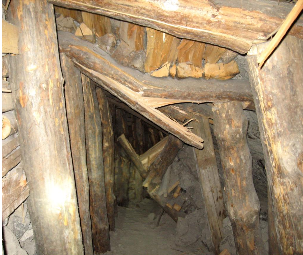
Fot. 8.1.5 Złamane fragmenty drewnianej obudowy, zejście Lichtenfels, poz. Lobkowitz (CII), KS Bochnia.
