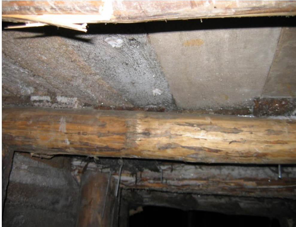
Fot. 8.1.18 Nierównomierna destrukcja ociosów w poprzeczni Franciszek 3; poz. A. Mickiewicza (II n), KS Wieliczka.
