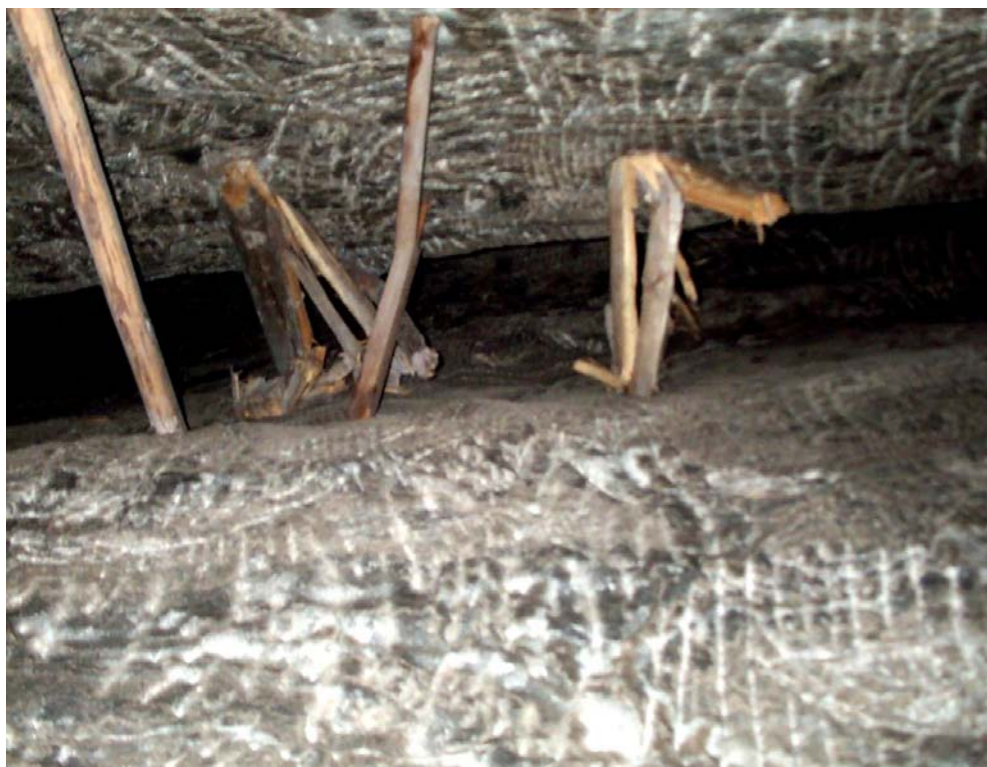
Fot. 8.1.7 Złamane fragmenty drewnianej obudowy, komora Stanetti, poz. Wernier (FV), KS Bochnia.
