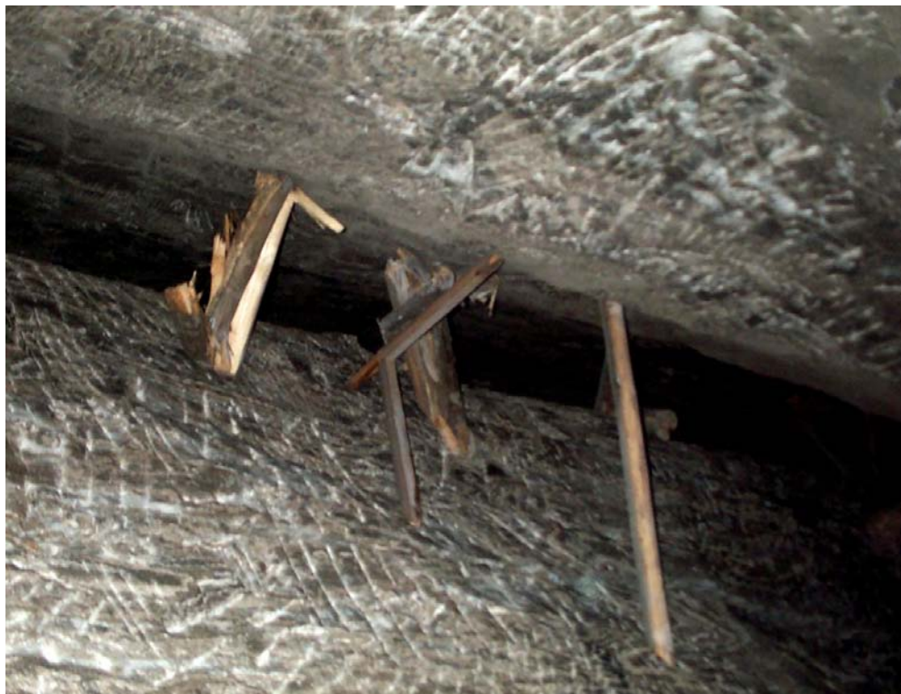
Fot. 8.1.6 Złamane fragmenty drewnianej obudowy, komora Stanetti, poz. Wernier (FV), KS Bochnia.
