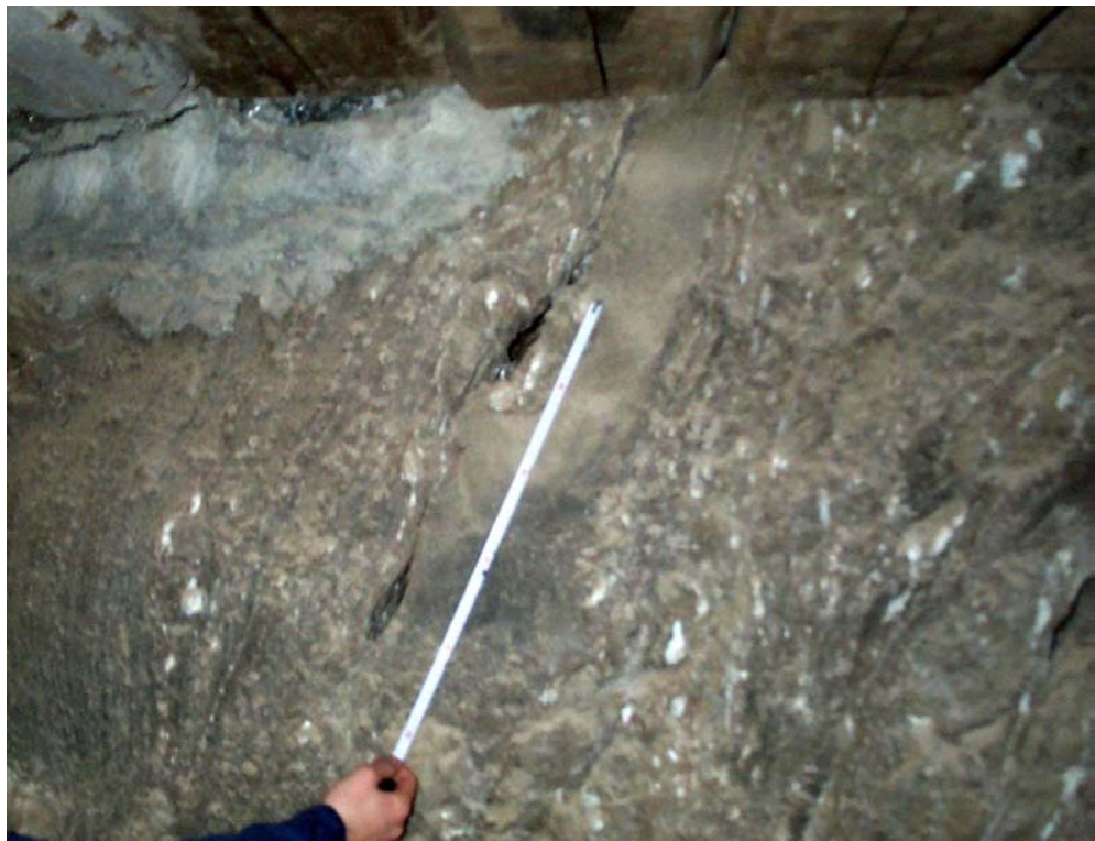
Fot. 8.1.2 Szczeliny rozwarte, kaplica św. Kingi, poz. August (CI), KS Bochnia.
