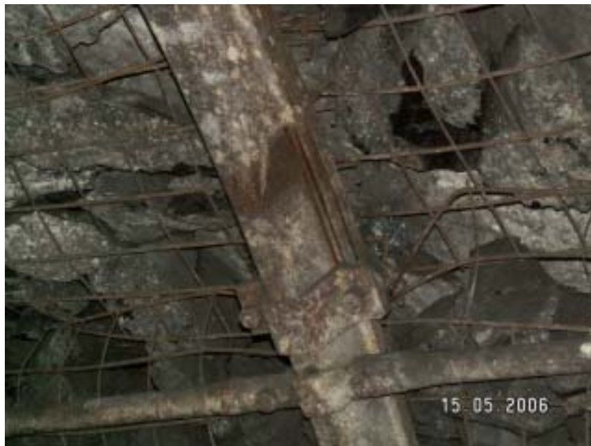
Rys. 6.11. Zsuw na obudowie chodnika 2a-E1 w pokładzie 703/1 - 335 m od dowierzchni IIa-E1
